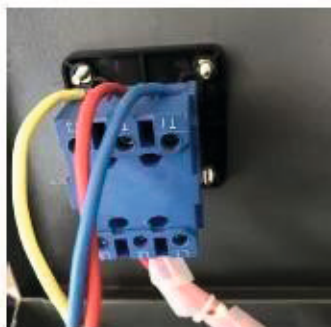
Raccordement du câble d'alimentation
